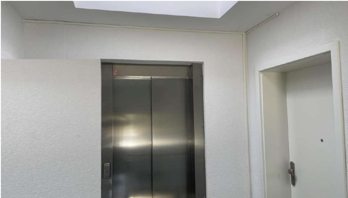
Abbildung 21: installierter Metallkanal in einem Treppenhaus (Quelle: DT)
