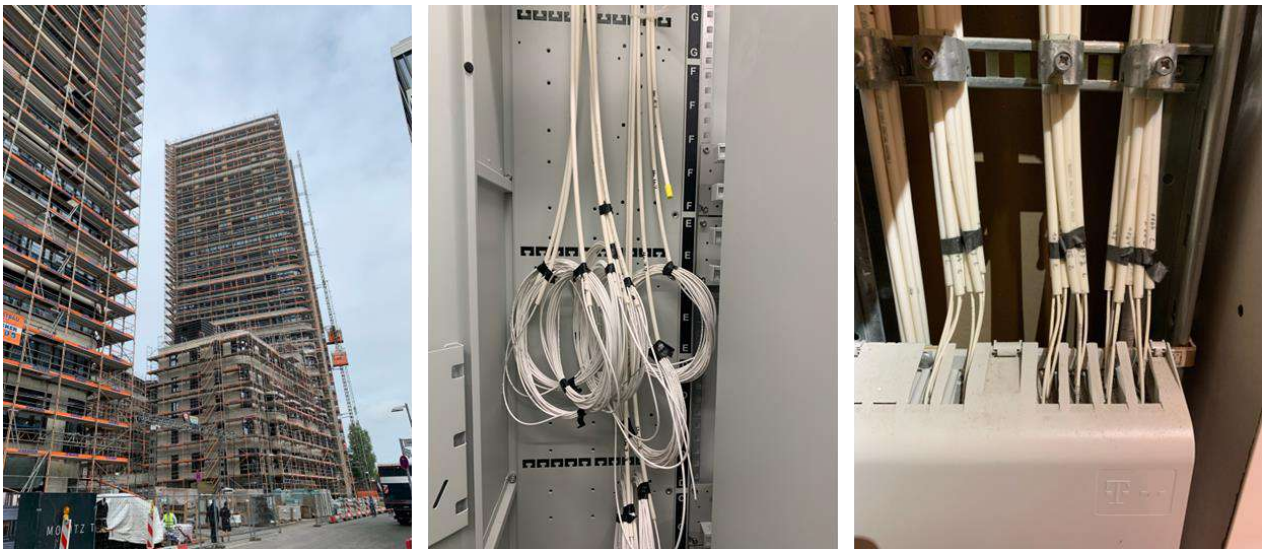
Abbildung 13: Mikrorohrinstallation in einem Neubauhochhaus mit 25 Etagen (Quelle: DT)
