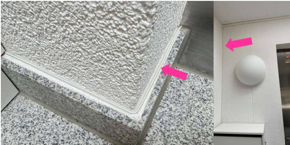
Abbildung 53: „Clear Track“ in einem Treppenhaus installiert (Foto: Zerson)
