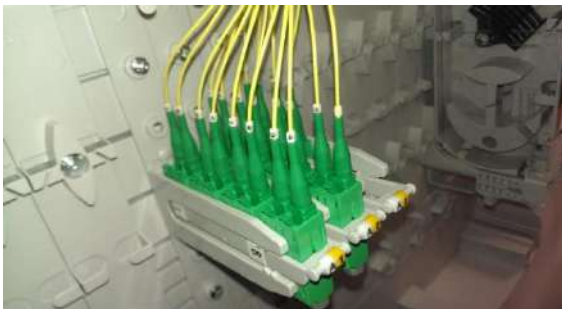
Abbildung 44: Beispiel einer übersichtlichen Steckerablage im Glasfaser-Gebäudeverteiler (Gf-GV) (Quelle: DT)
