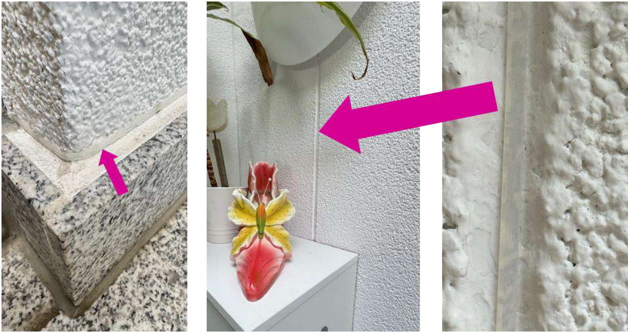
Abbildung 55: Selbstklebendes transparentes Kabel in einem Treppenhaus installiert (Foto: Zerson)
