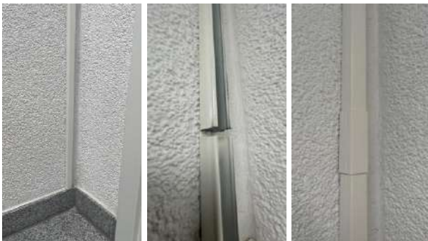
Abbildung 20: Metallkanal und Schnittkaschierung in einem Treppenhaus (Quelle: DT)
